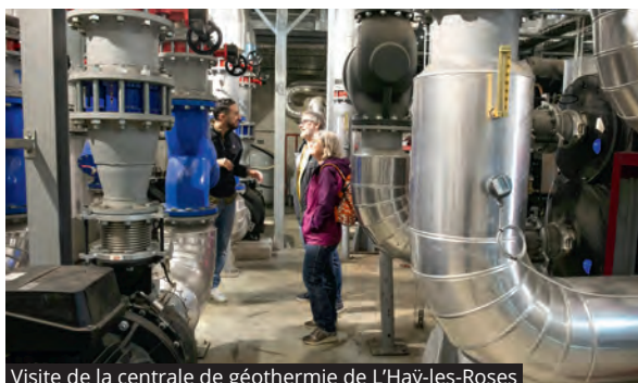
Visite de la centrale de géothermie de L'Hay-les-Roses
